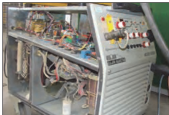
شکل ۱۱- ساختمان داخلی رکتیفایر
